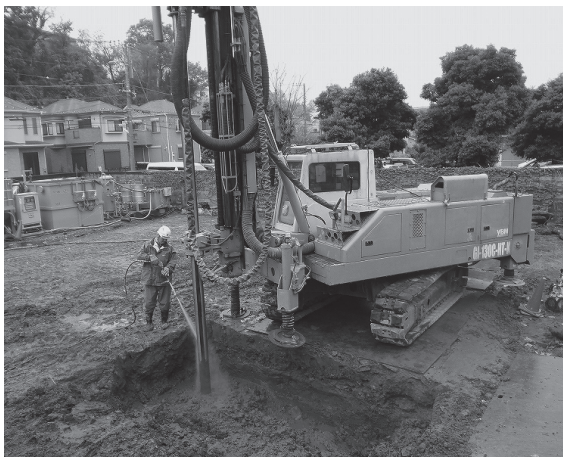
写真2 / 柱状改良機によるフェントン反応剤の攪拌混合 施工風景
